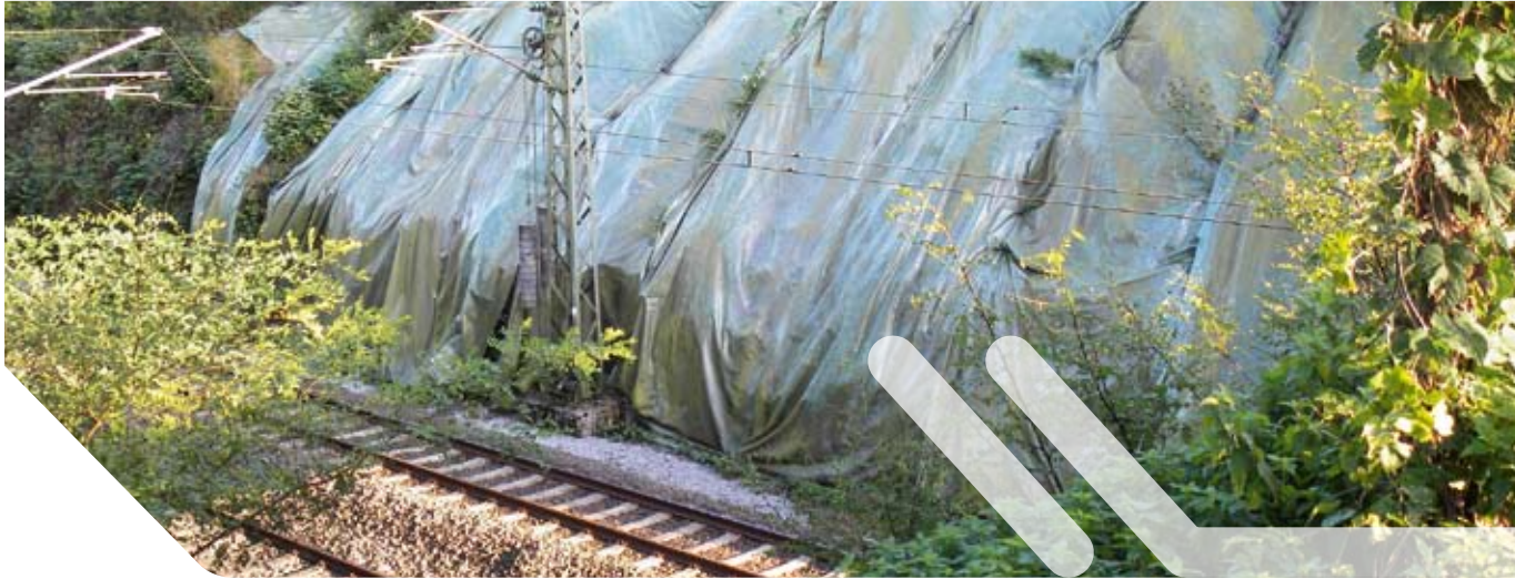
Hangsicherung zwischen km 77,8-77,9 (30 km/h)
