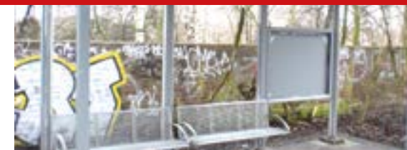
Fehlende Seitenscheiben und zerstörte Vitrine im Wetterschutzhaus sowie Graffitiverschmutzung
